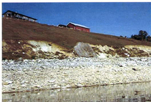
Bilde 6. På gården Førnes, like sør for de omtalte rasene er deler av den dyrka jord rast ut. Bilde fra våren -98
