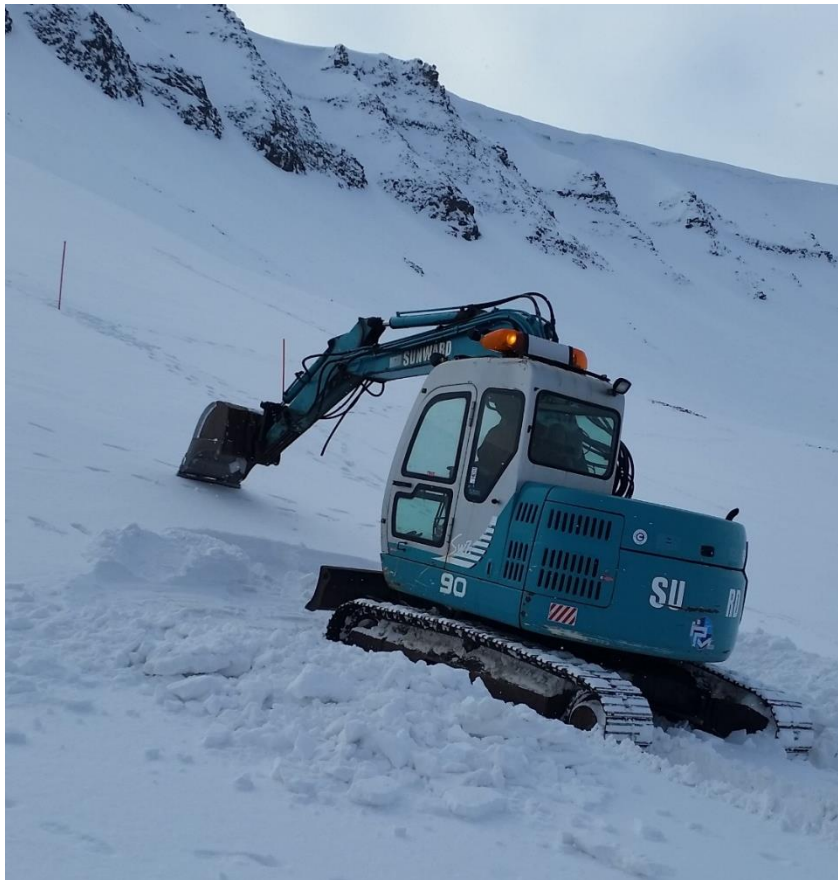
Figur 23: Viser det planlagte monteringsstedet merket med stikker til venstre i bildet og det endelige monteringsstedet som gravemaskinen er i ferd med å grave ut for. Gravemaskinen står så langt opp i skråningen som det var mulig å komme med maskinen. Foto: Jan Are Jacobsen.
