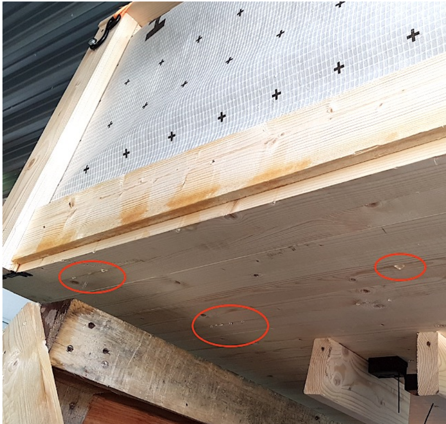
Figur 61: Avrenning fra kantstilt massivtre. Sirkler viser områder hvor vannet renner tvers gjennom elementet.
