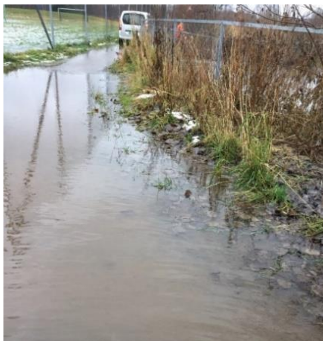
Figur 5. 4 viser oversvømmelse på gangfelt i området Måsabekken renseparken..
