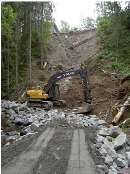
Figur 41. Øvre panel: Ras ved Hobølelva ved Våler. Elva er rett bak fotografen. Midtre bilde: Raset presset elva over mot høyre bredd, og skapte en bratt og meget ustabil elvebredd. Nedre bilde: Ras rett nedstrøms Mjær. Elva ble foreløpig lagt i kulvert under den midlertidige anleggsveien i forgrunnen av bildet (Alle foto Eva Skarbøvik)
