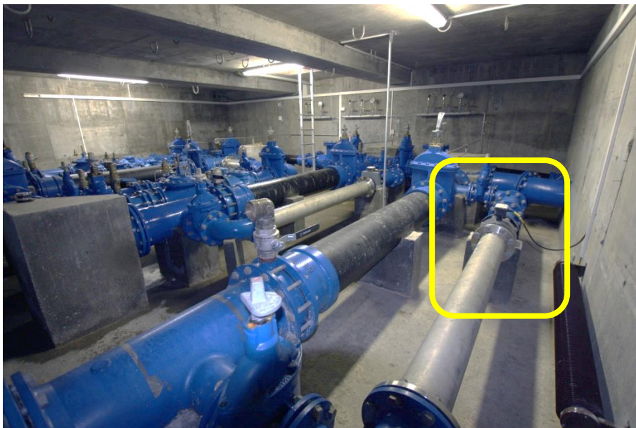
Figur 11. Bilde fra innsiden av en reduksjonskum, med elektromagnetisk mengdemåler (VAV)
