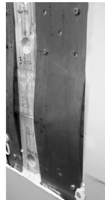
Foto 13: Deformert stålplate i trapperom (Eget foto)
