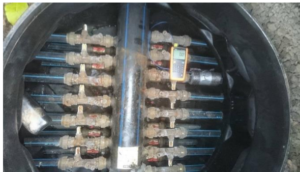
Figur 41: Fotografi av sammenkobling mellom tur-samlestocken til varmepumpa og 15 av de 30 brønnene. Rørene som forbinder brønnene til samlestocken er av PE og tåler ikke temperaturer over 30°C
