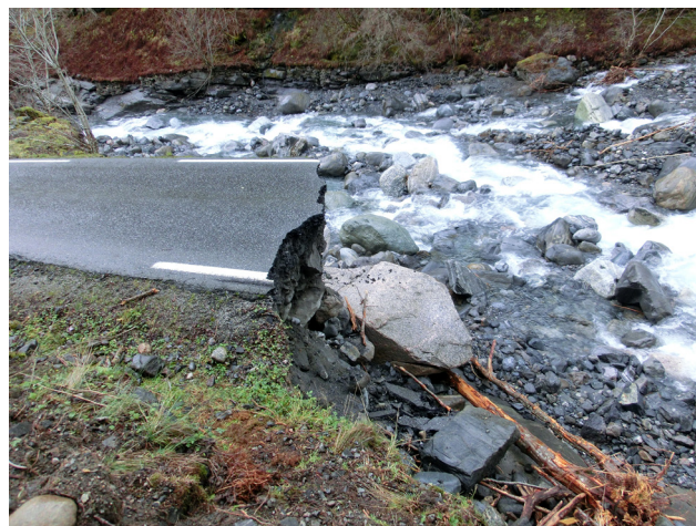
Den 28. oktober gjekk det gale. Då kom det så mykje lokal nedbør at elva fløynde over og tok med seg 30 meter av vegen
