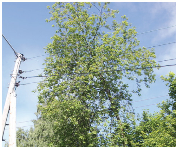
Figur 45 Høn Stasjon, Vestfoldbanen. To trær er på vei til å dette over kraftledningen. Dette krever skjøtselstiltak. (Larsen, 2015)
