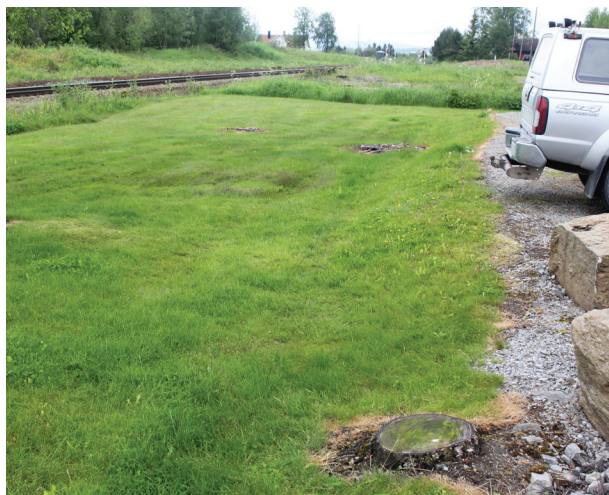
Figur 35 Sparbu stasjon, Nordlandsbanen. Mangelen på en avgrensning, resulterer i at bilene parkerer på plenarealet. Plenen får slitasjeskader, og grusen glir utover.
