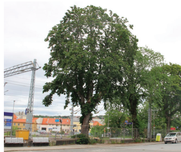
Figur 44 Halden stasjon, Østfoldbanen. To kastanjetrær og en alm vokser ut mot kjøreledningen. Dette krever sikkerhetstiltak. (Larsen, 2015)
