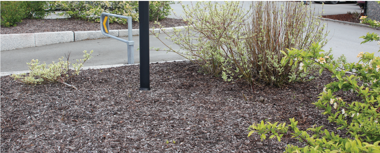
Figur 27 Vikhammer stasjon, nordladsbanen Vegetasjonen mistrives, og har fått tydelig redusert bladvekst etter en hard vinter.
