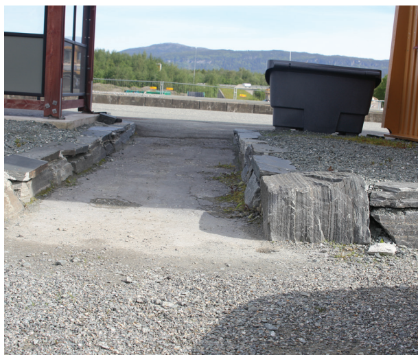
Figur 33 Hell stasjon, Nordlandsbanen. Grus og asfalt er en salig blanding på denne stasjonen. Dette gir et lite pent estetisk uttrykk. (Bredevold, 2015)
