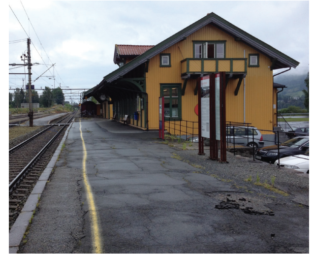
Figur 23 Vikersund stasjon, Bergensbanen. Stasjonen har et grått og lite innbydende uttrykk, da nesten hele stasjonen er asfaltert. Asfalten er i dårlig stand.
