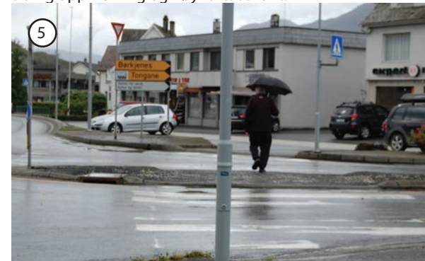
Fig. 3.050. Gangfelt som krysser Fv.34. Ujevn overflate og høy midtrabatt.
