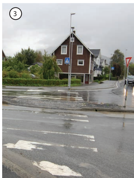
Fig. 3.105. Dagens gangfelt bærer preg av slitasje.
