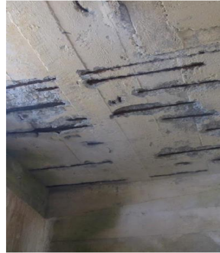
Figur 61: Avskalling på grunn av armering korrosjon i undersiden av dekke. [20]
