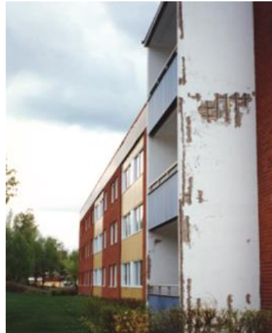
Figur 57: Korrodert armering på fasade. [26]
