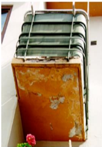
Figur 59: Kraftig korrosjon av armering i karbonatisert betong langs platekanten av balkong. [27]
