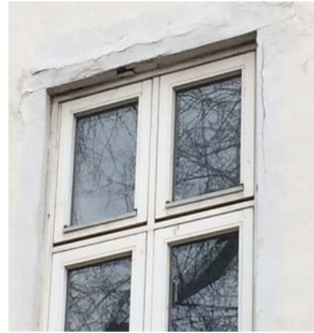
Figur 58: Korrodert armering over vindu. [25]
