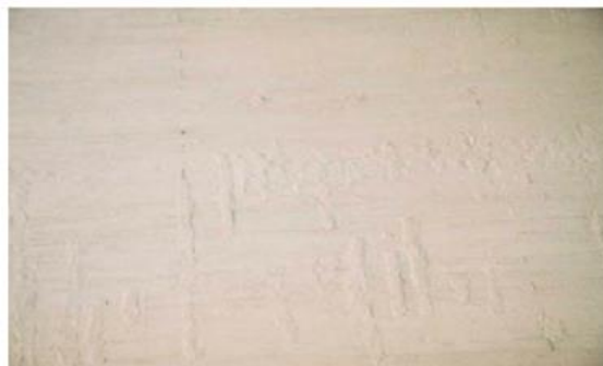
Figur 42: Svært synlige og lesbare reparasjoner. [23]
