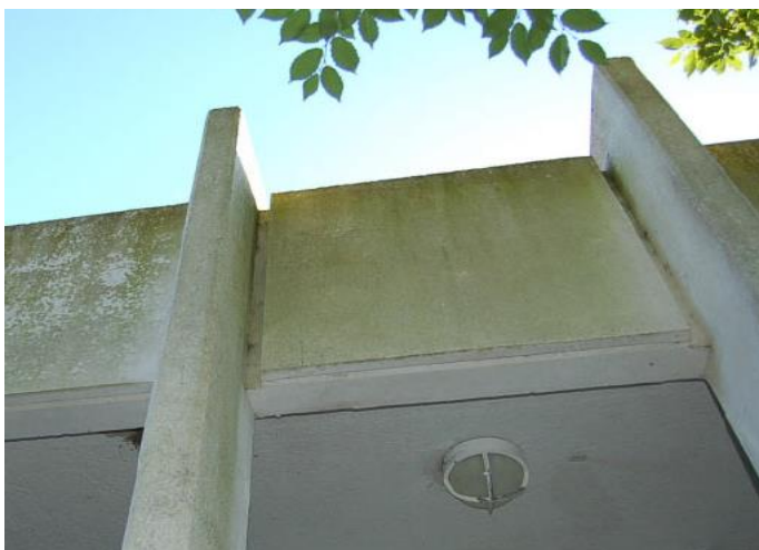
Figur 23: Begroing av grøninalger på gesims og søyler i svalgang på Gand kirke. [24]
