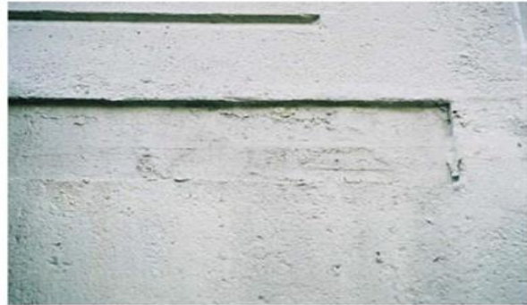
Figur 46: Endre overflatestruktur på grunn av sandblåsing. [23]
