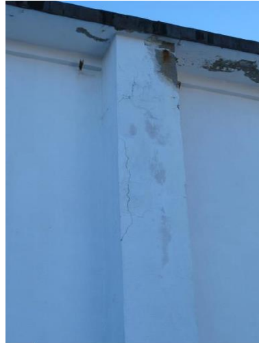
Figur 60: Synlig armeringskorrosjon på søyler utvendig og underkant dekke i kjeller (Stamsund kirke, bygd i 1937). [20]
