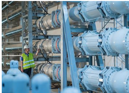
Figur 3.7 Grensesnitt mellom GIL-rør og GIS-bryter i Kina. Bildet er publisert med tillatelse fra Siemens.
