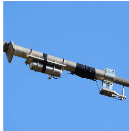
Figur 3.9 Vibrasjonsmåler installert i enden av et av Statnetts fjordspenn. Bildet er publisert med tillatelse fra Statnett.
