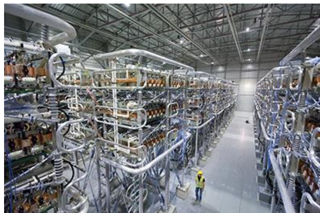
Figur 3.6 Omformerhall med IGBT-transistorer for HVDC-overføring mellom Frankrike og Spania. Bilde er publisert med tillatelse fra Siemens.
