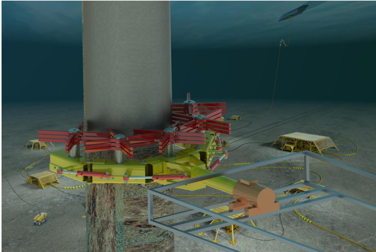
Figur 80: Verktøyet rengjør en søyle med en diameter på 750 millimeter subsea (Rammefarge: RAL 1004).
