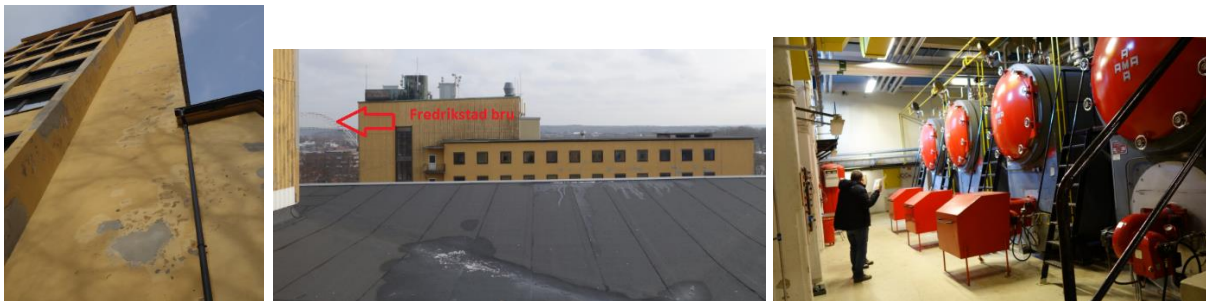
Figur 7 Sørfasaden til blokk A, takbildet på blokk B og fjernvarmeaggregater i teknisk rom på U. etasje. (Lu)
