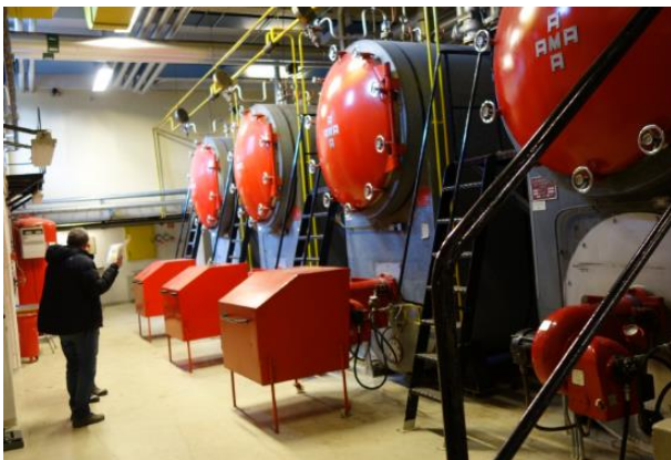
Figur 17 Eksisterende varmevekslene fra Fredrikstad fjernvarme AS. (Lu 2016)
