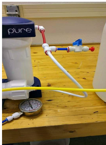
Figur 3-7: Installert ventil for mulighet til prøvetaking etter filter. Foto: Ingrid Marie Johnsen.
