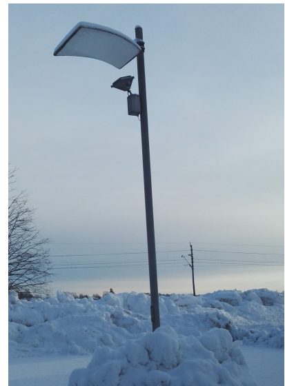
Figur 5.5: Belysningssystem som benytter speil, Elkjøp Dikeveien i Fredrikstad.
