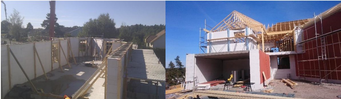
Figur 1 Thermomur under støp og etter. Eneboligen til høyre skal kles med panel.
