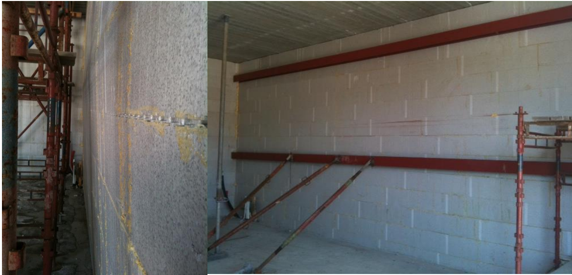
Figur 10 Eksempel på brudd i Thermomur og etterfølgende sanering.
