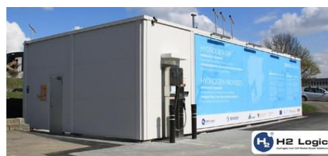
Figur 9: H2 Logics hydrogenfyllestasjon (Fuelcelltoday, 2012).
