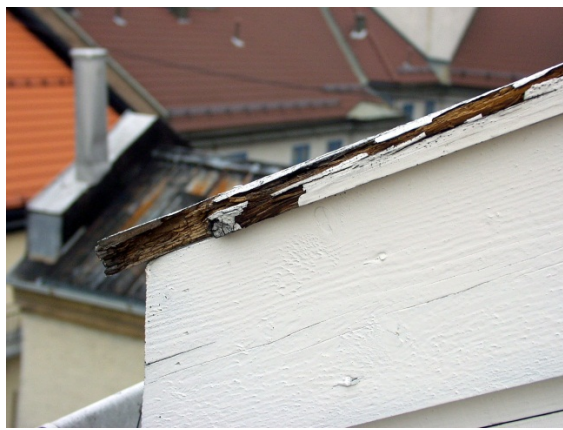
Figur 2.4.2. Vannbord har kort levetid hvis det ikke er montert beslag. (Foto: Mycoteam as)
