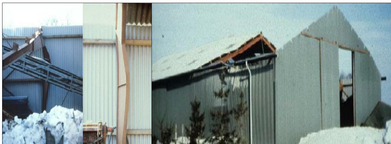
Figur 1.3: Kollaps av stålramme med ekstremt slanke stålbjelker [6]
