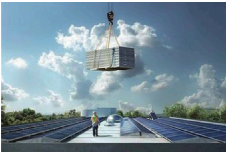
Figur 15: Powerhouse Kjørbo, solcellepanel på tak.(Futurebuilt)
