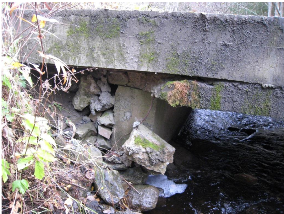
Figur 25: Landkar i dårlig forfatning. Betongplatebro støpt ovenpå eldre bro. Sted: Enebakk. Foto: Ole Stabekk, 2013.
