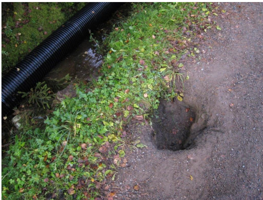
Figur 24: Hull med størrelse 30 x 30 cm i vei grunnet betongrør som har glidd fra hverandre. Sted: Enebakk. Foto: Ole Stabekk, 2013.
