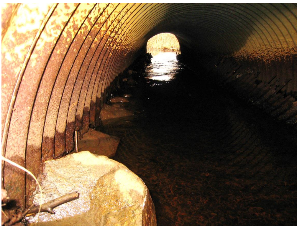
Figur 4: Kulvert i stål sterkt angrepet av rust, Enebakk. Foto: Ole Stabekk, 2013.
