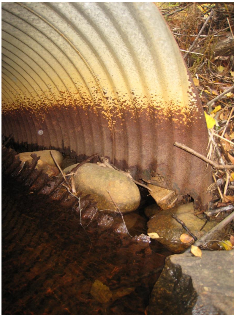
Figur 23: Kulvert med diameter på 1000 mm angrepet av rust. Kulverten er delt i to langs hele vannlinjen. Sted: Enebakk. Foto: Ole Stabekk, 2013.
