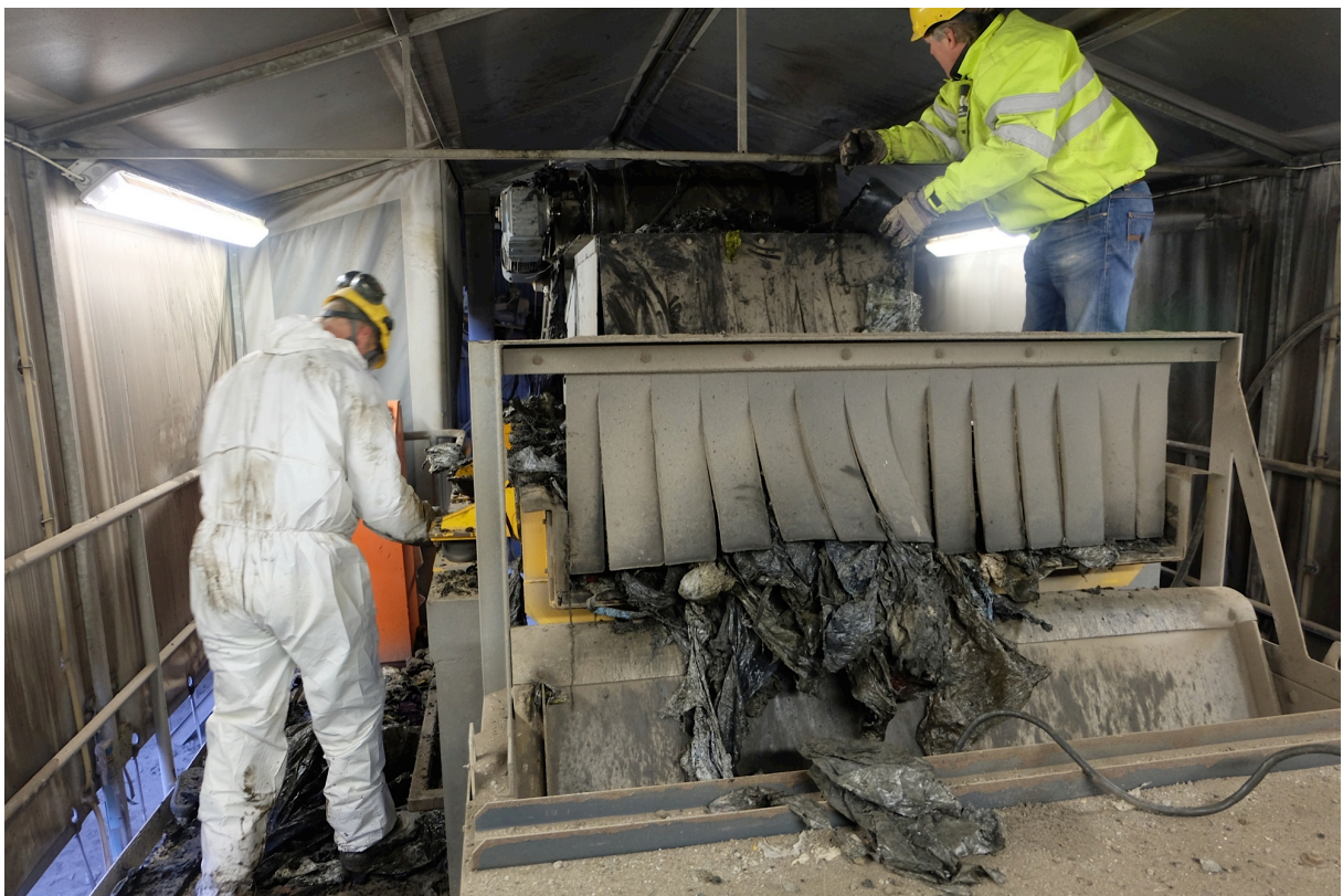
Figur 15 Opphopning av avfall ved luftseparator. Foto: Knut Erik Haugen
