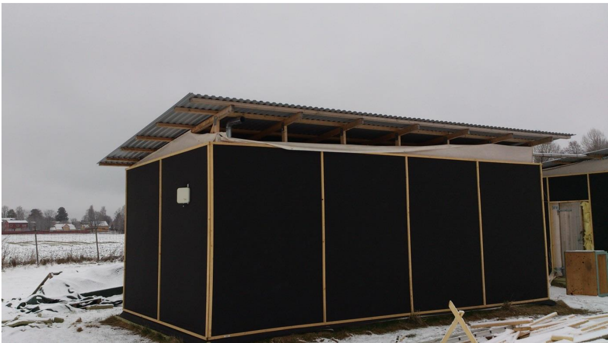
Figur 26: Bildet viser hvordan vindduken har løsnet mellom vegg og tak på sørsiden av modul A og kan føre til at vind kommer inn til modulen via utettheter. I bakgrunnen kan en se modul B som skjermer på østlig side.
