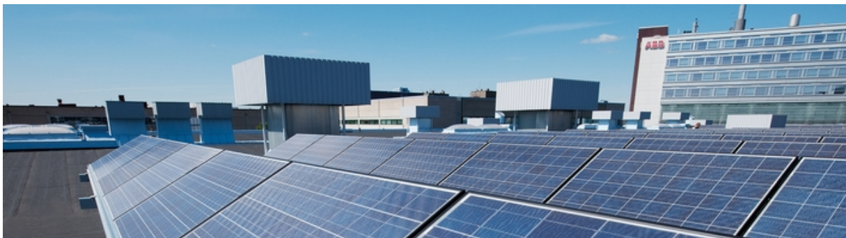
FIGUR 7.1: EKSEMPEL PÅ SOLCELLEPANELER MONTERT PÅ FLATT TAK (JANSRUD U.Å.).
