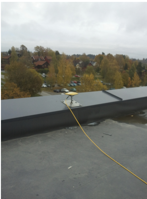
Figur 4.3: Oppsett på taket av Palisaden. Omtrent same plassering på begge bygga.
