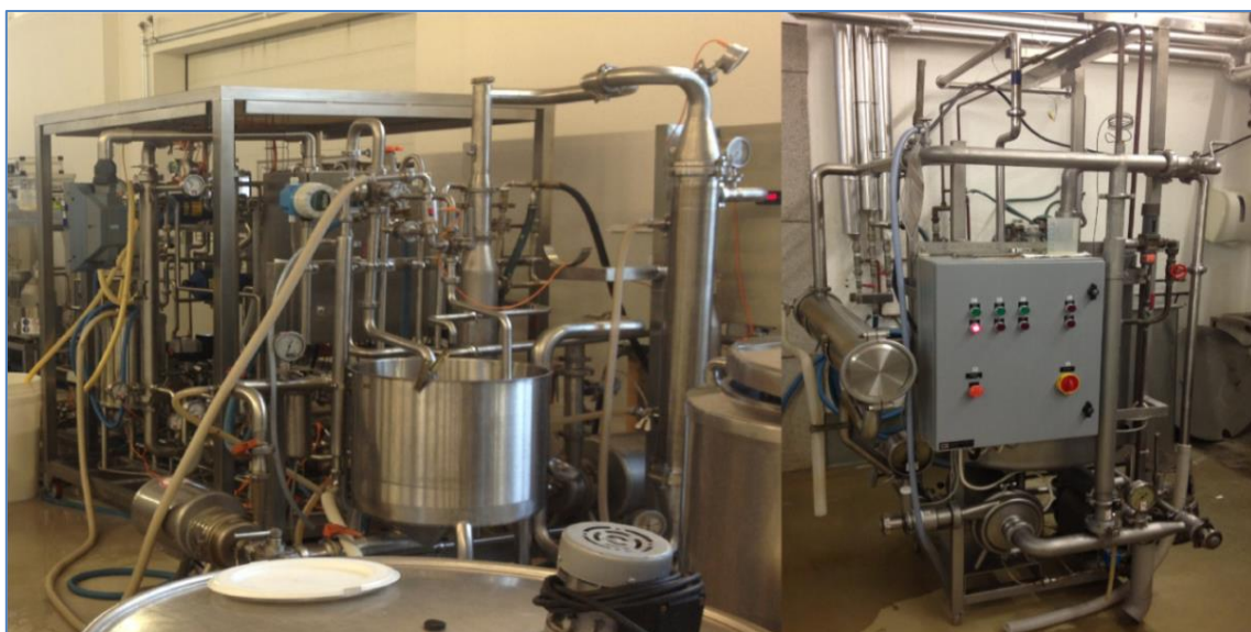
Bilde 4.8 Mikrofiltrerings anlegg til venstre med permeattank i forkant, Ultra Filtrerings anlegg til høyre med filtermodul montert liggende (Even Gausemel)
