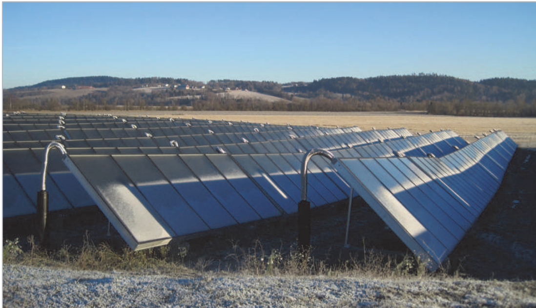
Bilde 2-1: Deler av solfangeranlegget ved Akershus Energipark, 22.11.2013 (Foto: Reidun M. Romundstad).
