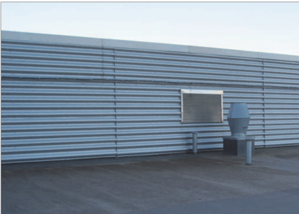
Bilde 3-9: Ventilator plassert inn mot veggen på den sørøstlige siden av takflate 4 (Foto: Reidun M. Romundstad).
