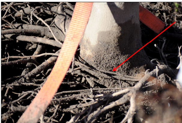
Figur 84. Tynnere røtter lå i ring rundt rothalsen (rød pil) og kunne på sikt ført til kvelning av rothalsen (9.10.13).
