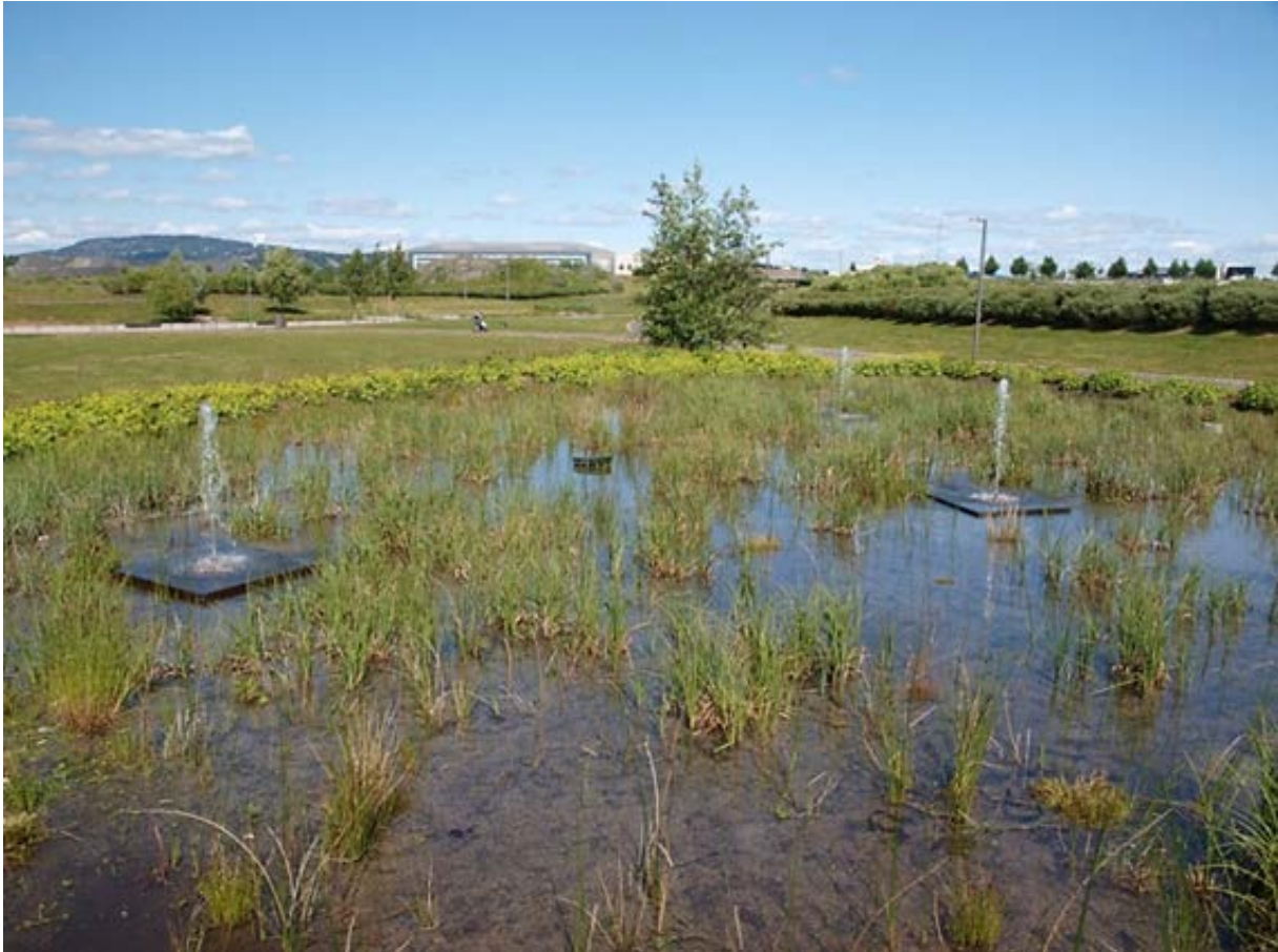
Bilde 21: viser vannfordeling i Biofilter 3. Fordelingspunktene er påmontert dyse, i tillegg er utløpsrøret fra biofilteret justert slik at filteret driftes mettet med et overliggende vannspeil.
