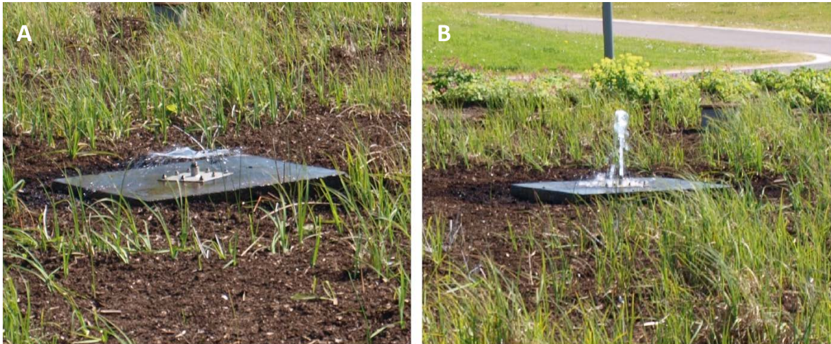
Bilde 16: viser fordelingsanordninger på Biofilter 1 før driftsendring. Ved to av fordelingspunktene var det påmontert forstøvingsdyser (A) og ved et fordelingspunkt var det påmontert strupeventil (B). Overflaten av filteret er dekket med Oslotorv.
