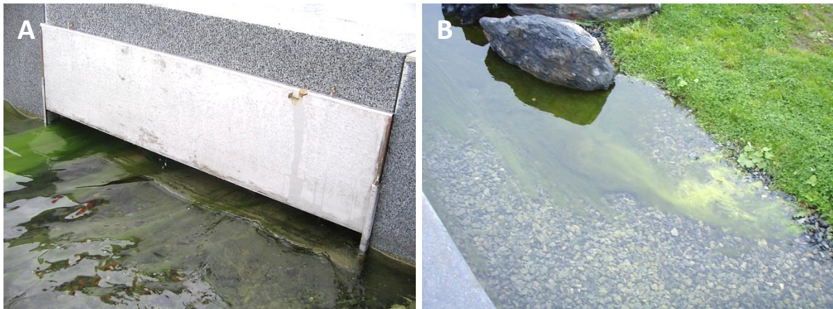
Bilde 1: Bilde A viser algevekst ved et av vanninntakene til pumpehuset, mens bilde B viser algevekst i vannkanalen (Foto: Kim Paus)
