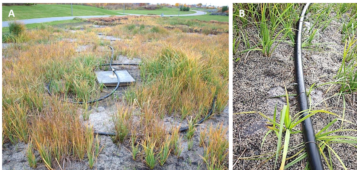
Bilde 20: Viser fordelingsanordningen til Biofilter 2 etter ombyggingen. Bilde A viser hvordan PE rørene er lagt i sirkler utover filterflaten, mens bilde B viser hvordan vannet tilføres filterflaten.
