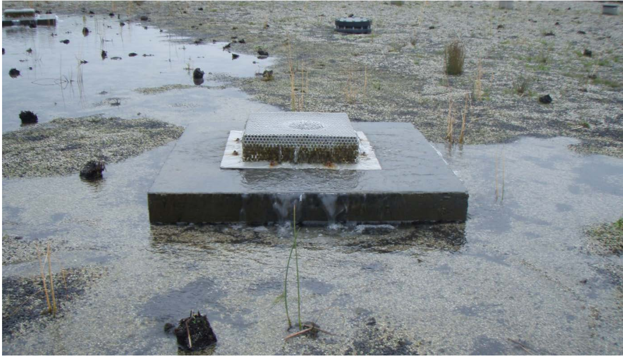
Bilde 27: viser det opprinnelige systemet for vannfordeling som ble etablert i 2008. Gitteret på toppen skal hindre at dyr, e.l. faller ned i tilførselsrøret.
