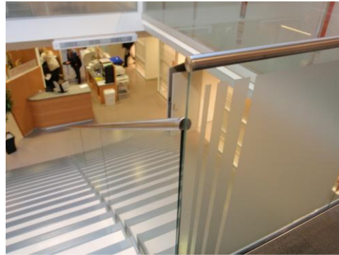
Figur 20; håndlisten er i en høyde og er ikke sammenhengende.
