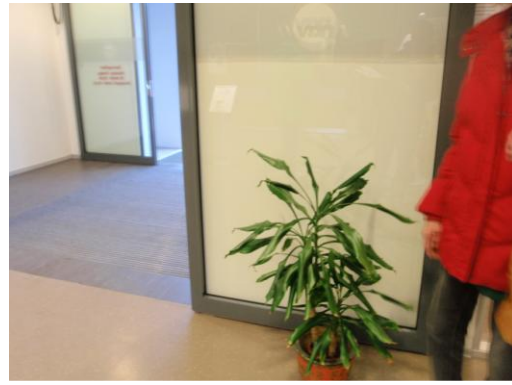
Figur 34; når den automatiske døren åpner seg kan man risikere å få hånden i klem mellom veggen og døra.
