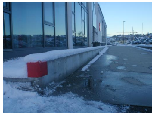
Figur 6;man har markert nesene på betongkantene med rødt for å unngå sammenstøt.
