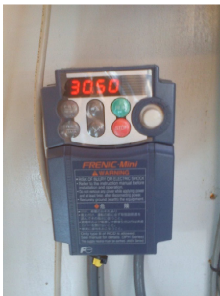
Figur 5.2: Frekvensomformereren til pumpe 1. Foto: Helle N. Sætre
