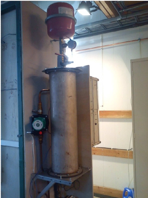
Figur 5.4: Vannvarmeren med den grønne sirkulasjonspumpen og den røde ekspansjonstanken. Foto: Helle N. Sætre
