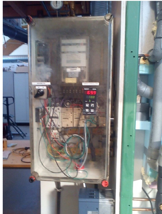
Figur 5.5: Energimåler og regulator for vannvarmeren. Foto: Helle N. Sætre
