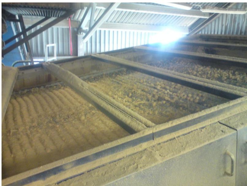
Figur 22 Rullesoldingsanlegg, der de forskjellige fraksjonene faller igjennom ettersom de treffer en glippe mellom rullene som passer fraksjonsstørrelsen. Overgrovt faller ikke igjennom noen av glippene men går ut som avfall.
