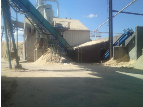
Figur 10 Bygning med dagens mølle- og soldingsanlegg. Transportøren som går opp til venstre i bildet frakter flis opp til silo.
