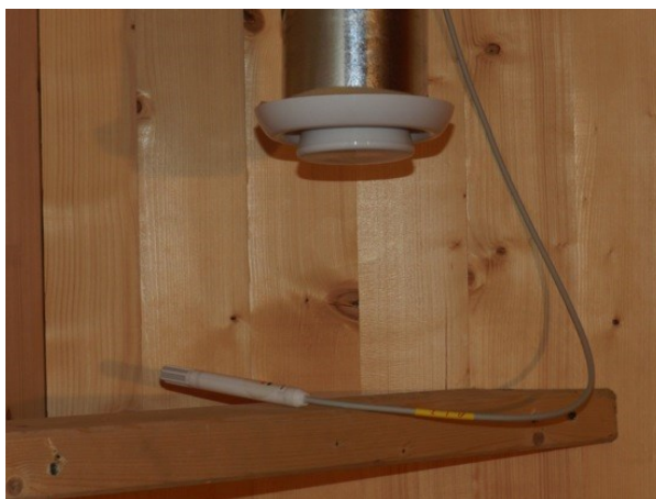
Bilde 2: RF-/temperatursensor under avtrekk i testhus A
