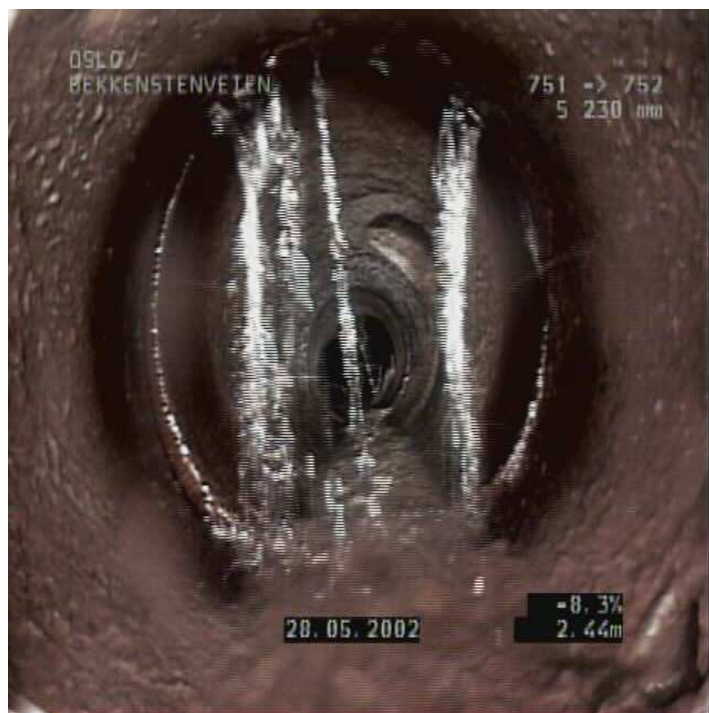
Figur 2. Skjerm bilde fra TV-rørinspeksjoner i avløpsledningsnett i Oslo.
