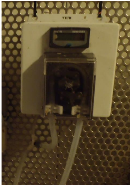
Figur 6-4 Gasspumpe, med mekanisk telleverk. Foto: Magnus Gjetmundsen.
