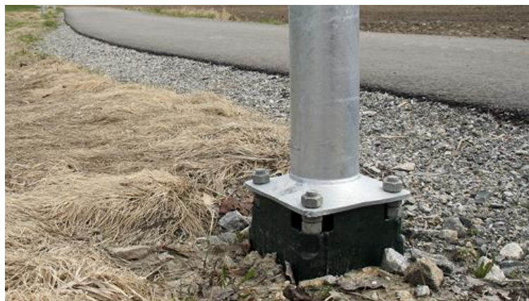
Figur 6: Lyktestolper benytter en type søyleføtter uten betongfundament.
