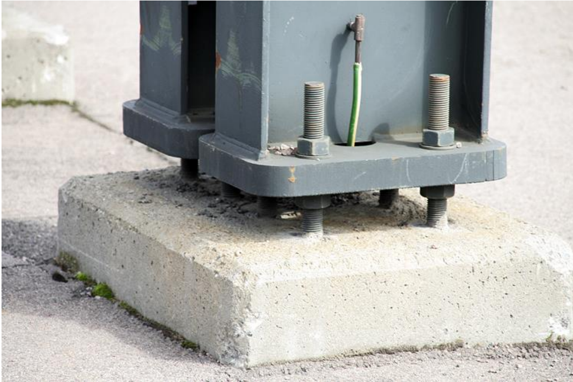
Figur 7: Mastene som holder oppe kjøreledningene til tog benytter søyleføtter.
