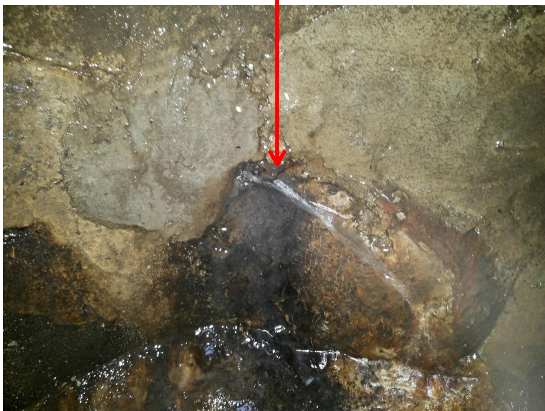
Figur 9.2.4. Påvist innlekkasje i kumvegg (SID: 248871) VMAL9_S5 ifm. feltundersøkelen
