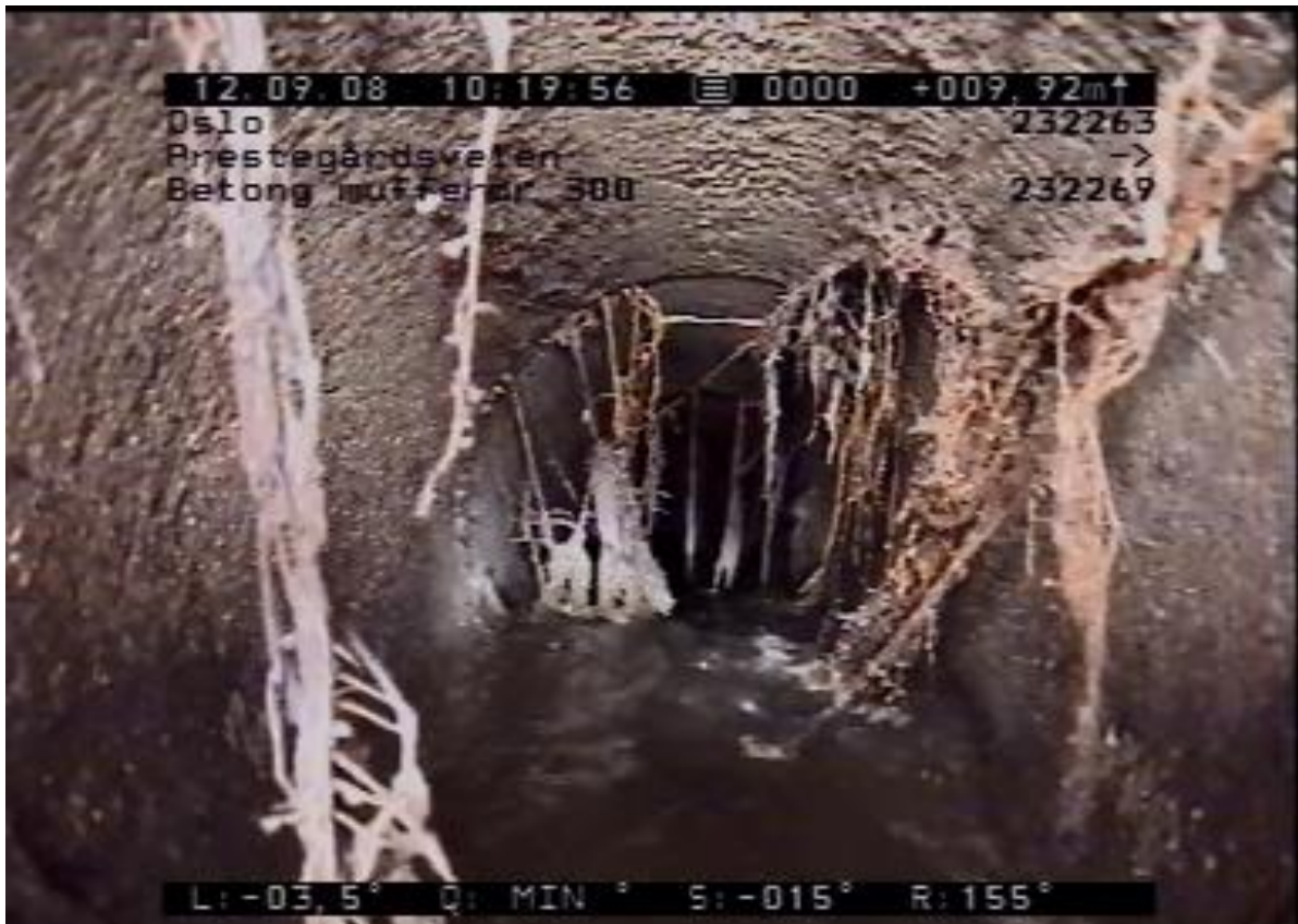
Figur 6.5.1. Begroing i avløpsledningsnett i VMAL9_S5, Prestegårdsveien i Oslo.
