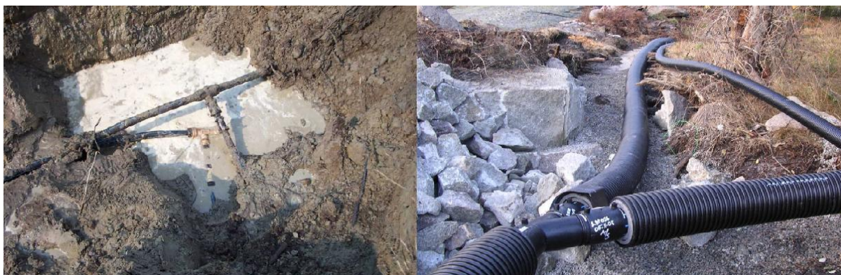
Figur 11: Eksempler på tilkobling av oppsamlingsledning til hovedledning med T- og Y-kobling (bilder hentet fra presentasjon av trykkavløp (SULZER, 2012))
