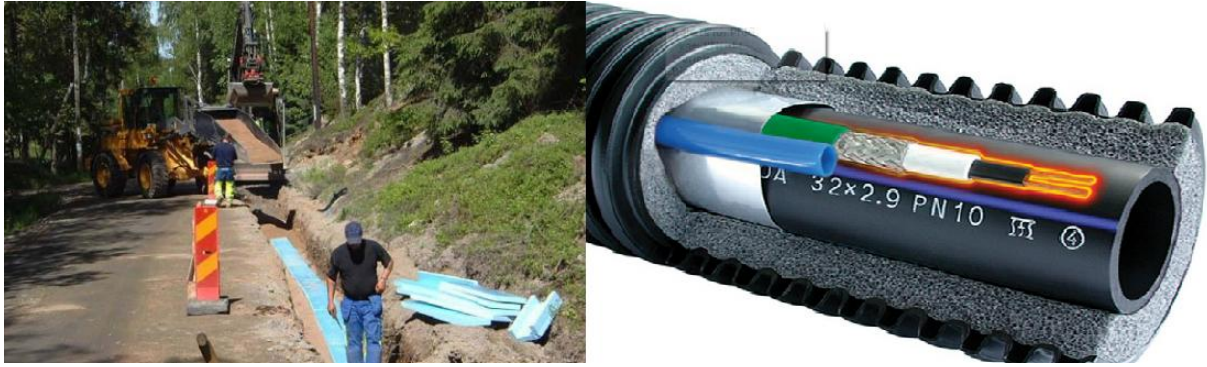
Figur 13: Til venstre: Grøft med rør i isolerte kasser (Skandinavisk Kommunalteknikk AS, 2012). Til høyre: Isolert rør med varmekabel (Opplandske Rørsystemer AS, 2011)
