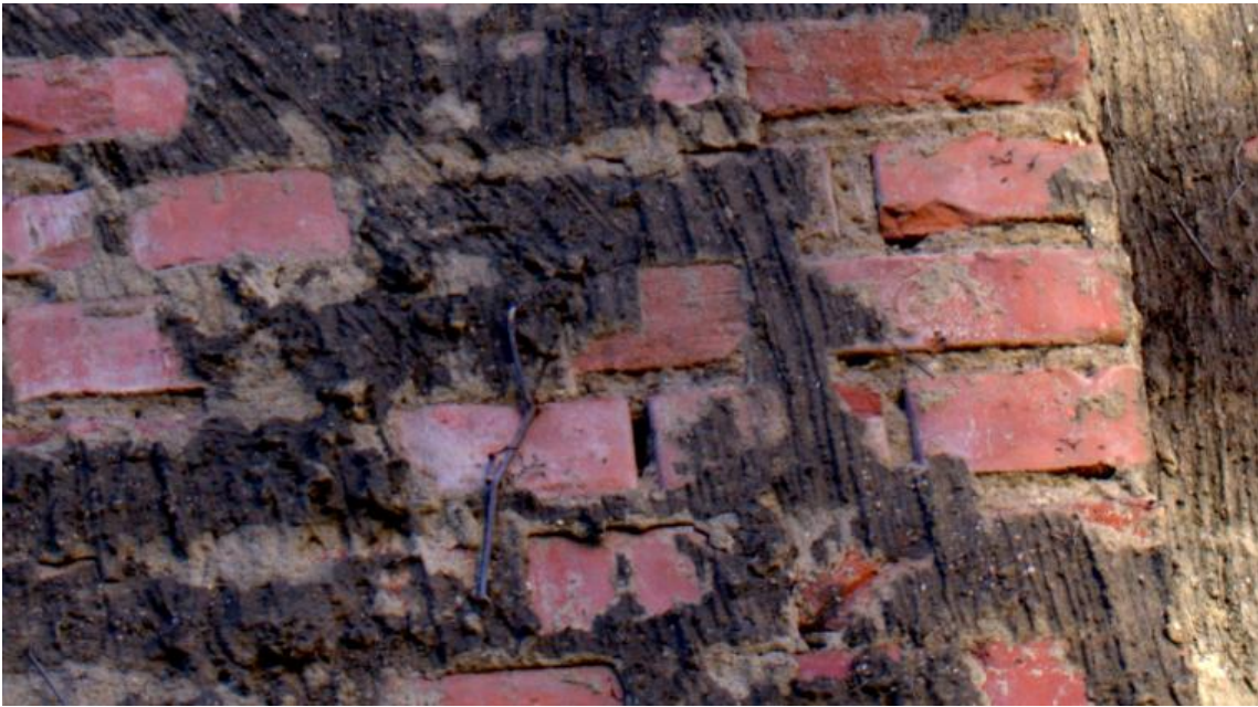
Forvitring av mørtelfuger, fasade nordvest (MWB)
