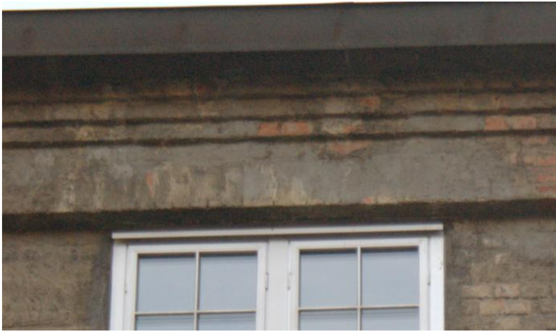
Kalkutslag, fasade nordøst (MWB)
