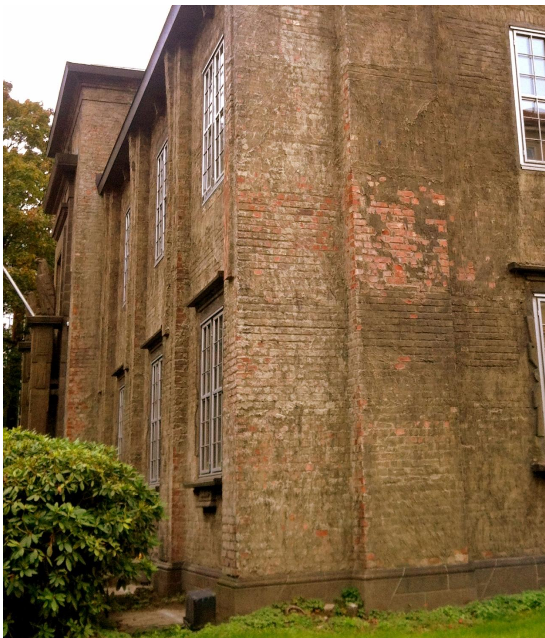
Avskalling av slemming, fasade nordvest (MWB)
