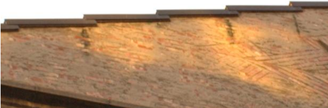
Fuktstriper, fasade sydøst (MWB)
