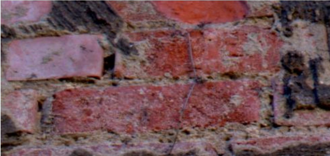
Tynne avskallinger/forvitring, fasade nordvest (MWB)
