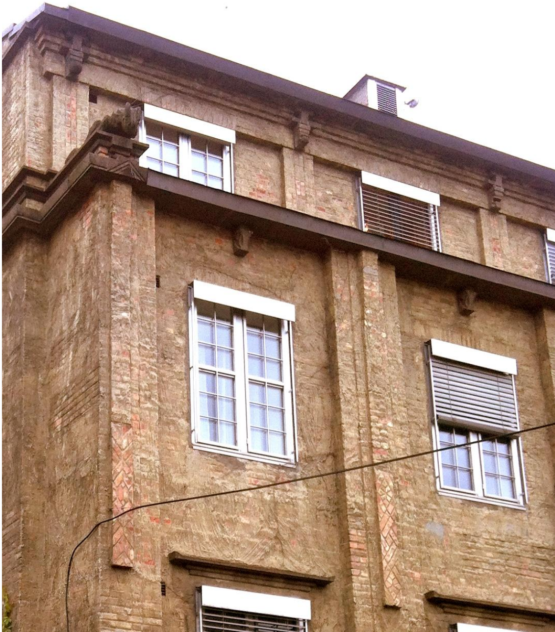
Avskalling av slemming, fasade sydvest (MWB)
