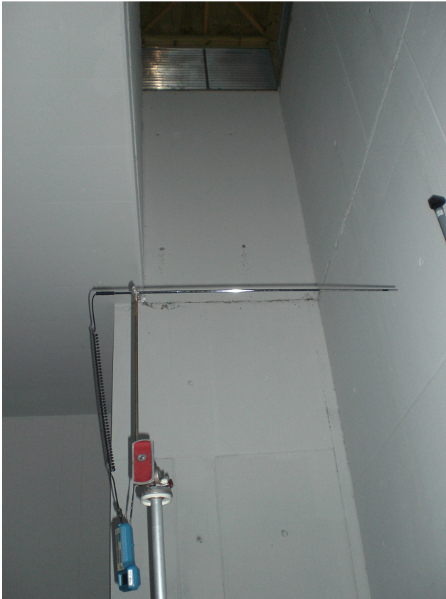
Bilde 18: Inntakskulvert med lufthastighetsmåler (Foto: Hans Magnus Jelsnes)
