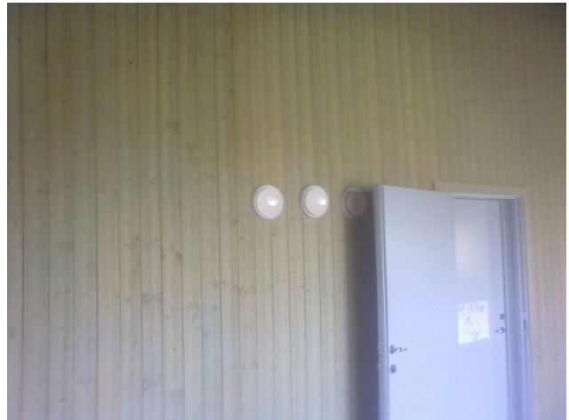
Bilde 11: Luftventiler i rom (Foto: Hans Magnus Jelsnes)
