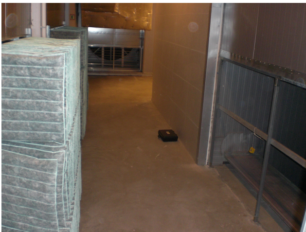
Bilde 16: Fordelingskulvert med begge viftene (Foto: Hans Magnus Jelsnes)
