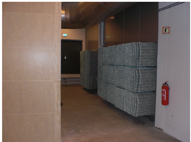
Bilde 17: Fordelingskulvert med filter (Foto: Hans Magnus Jelsnes)
