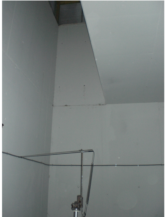
Bilde 19: Inntakskulvert med lufthastighetsmåler (Foto: Hans Magnus Jelsnes)
