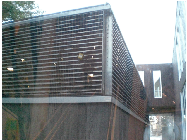
Bilde 15: Luft-inntakstårn med temperaturlogger montert (Foto: Hans Magnus Jelsnes)
