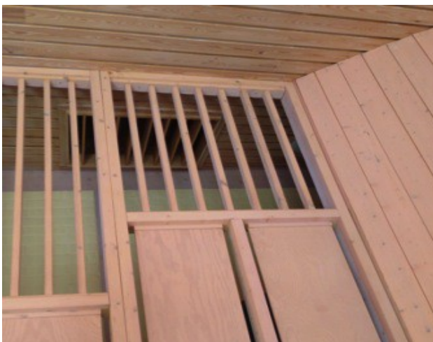
Bilde 12: Avtrekk i himling (Foto: Tormod Aurlien)
