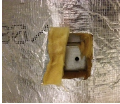
Figur 3.6 Hull i ventilasjonskanal
