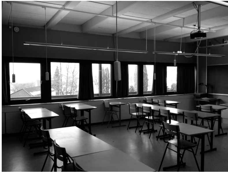
Figur 4.16 Bilde fra klasserom med skjøteledninger hengende ned fra taket
