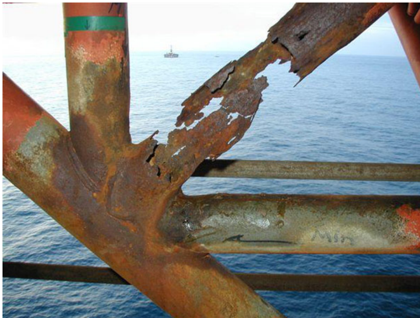
Figur 5.14. Ekstremt tilfelle der korrosjonsprosessen har fått holdt på. [19]
