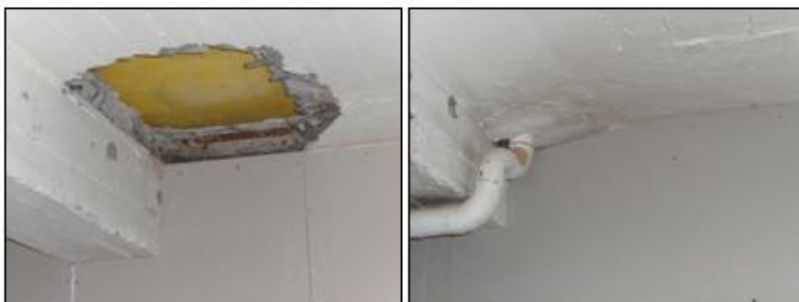
Figur 22: Åpning og gamle rør med lekkasje i eksisterende del (bilde av Mats C.J.S.)
