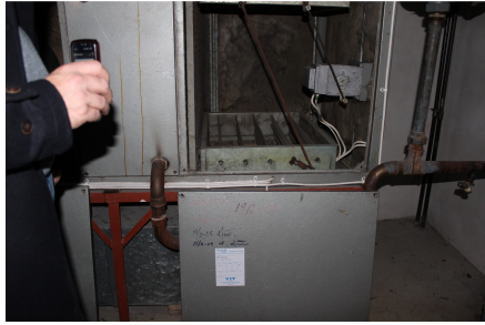
Figur 24: Bile av ventilasjon i gymsalen som ikke fungerer
