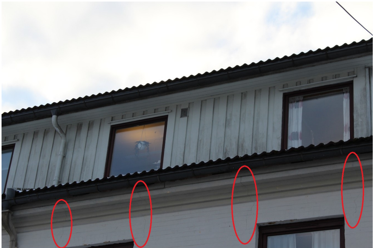
Figur 28: Sprekker i veggen på grunn av frostskaeder
