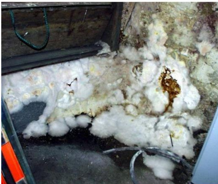
Bilde 2: Bildet viser et bygg angrepet av ekte hussopp. Kilde: Mycoteam
