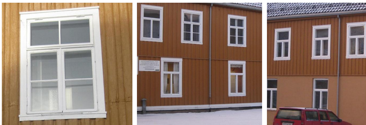
Figur 27. Vinduene ut mot gårdsrommet ser ut til å være i empirestil og sveitserstil (Bilde fra befarung til Trondheim, februar 2011).
