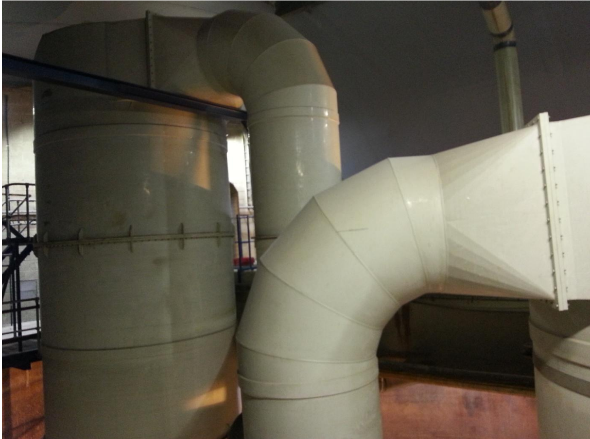
Figur 4-2: Strippeanlegget ved VEAS. Strippekolonnen i bakgrunnen til venstre og absorpsjonskolonnen til høyre.
