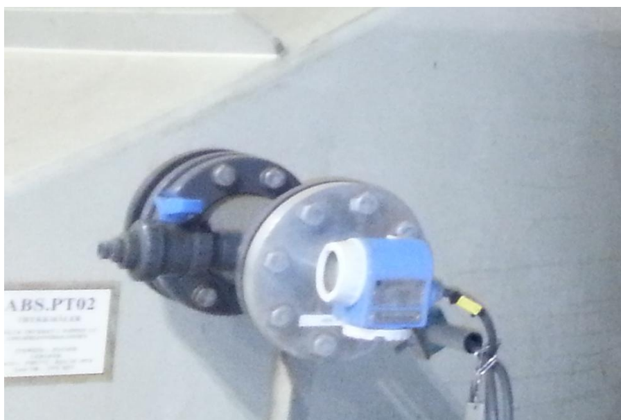
Figur 5-3: Trykkmåler ABS_PT02 plassert på topp av absorpsjonskolonnen.
