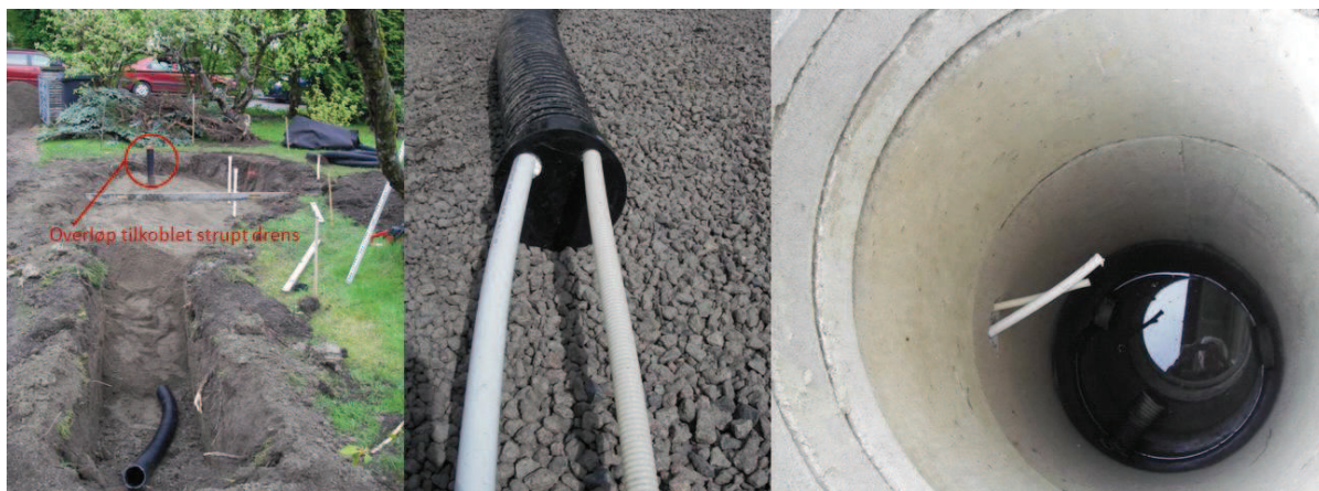
Figur 42. Utførelse av overløp- og strupt drenstilkobling til kommunalt ledningsnett. Foto: Bent C. Braskerud
