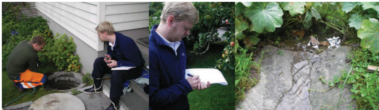
Figur B-2. Feltarbeid i NB21. Til venstre: Måling av dreivannføring i overvannskum. I midten: Resultatskriving fra målinger. Til høyre: Overløpsvannføring i steinsatt V-profil. Foto: Bent C. Braskerud
